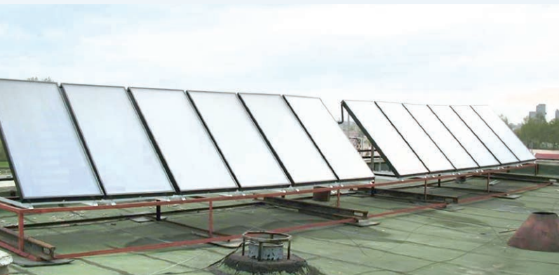
◆ Рис. 1. Гелиоколлекторы в локомотивном депо (ТЧ-10), г. Жлобин
