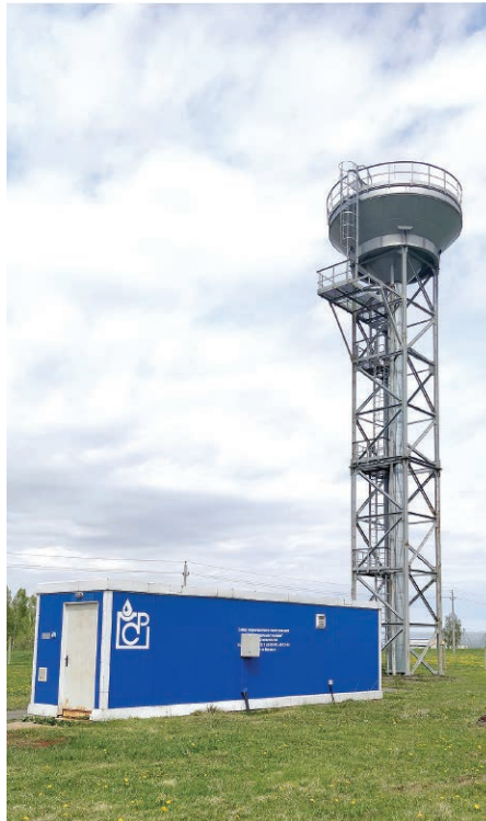
Рис. 2. Станция водоподготовки «Кристалл-НК» и водонапорная башня
