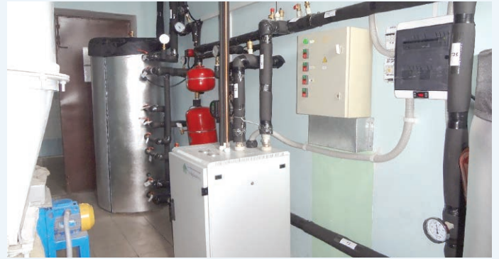
◆ Рис. 4. Реверсивный тепловой насос в локомотивном депо, г. Витебск
