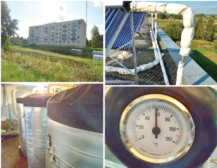
◆ Рис. 7. Вид на модернизированную систему горячего водоснабжения с установкой гелиоколлектора на крыше 5-этажного 60-квартирного жилого дома в деревне Обухово, ул. Связистов, д. 8 Оршанского района Витебской обл. [12]
