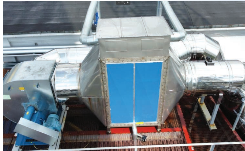
Рис. 3. Внешний вид конденсатора дымовых газов, установленного на крыше котельной
