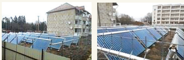
Жилые домах №1 и №2 в деревне Звездная по ул. Интерна-товская с установленными солнечными гелиоколлекторами для приготовления горячей воды, состоящими из солнечных панелей SCH30 и вакуумных трубок, размещенных на открытом воздухе недалеко от дома №2
