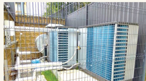
Горячее водоснабжение жилого здания в неотапливаемый период осуществляется при помощи двух тепловых насосов типа «воздух-вода» и комплекта накопительных емкостей
