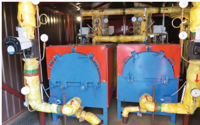
Водогрейные котлы в составе модульной транспортной котельной, работающие на pelletках
