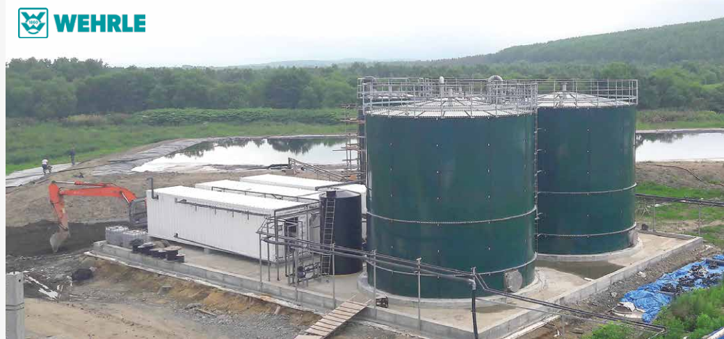
Рис. 3. Очистные сооружения свиноплекса – навоз из лагун
