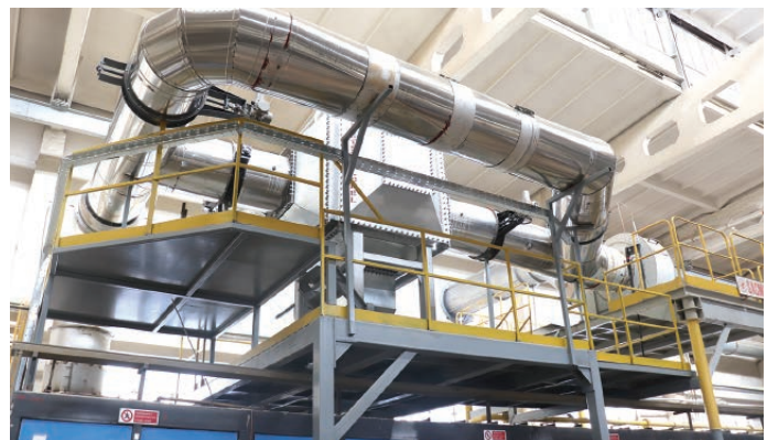
◆ Рис. 3. Утилизатор в ОАО «Березастройматериалы»
