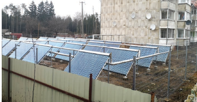
Гелиоколлекторы в жилых домах №1 и №2 в деревне Звездная по ул. Интернатовской
