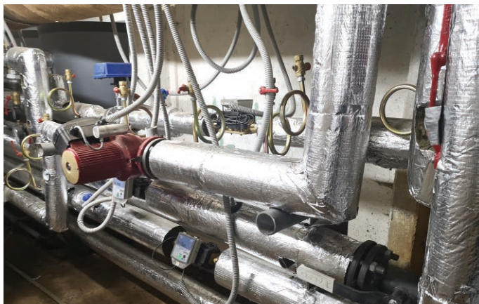
Теплотехническое оборудование в подвале жилого дома в деревне Звездная по ул. Интернациональная
