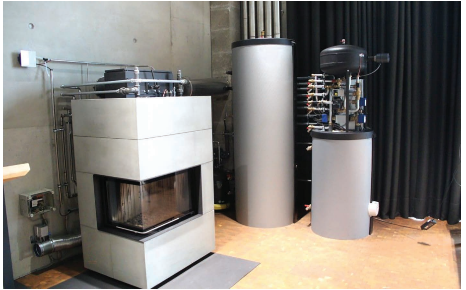
Так выглядит стандартная котельная с автоматизированным pelletным котлом
