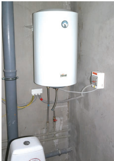
Электрический емкостной водонагреватель работает в автоматическом режиме
